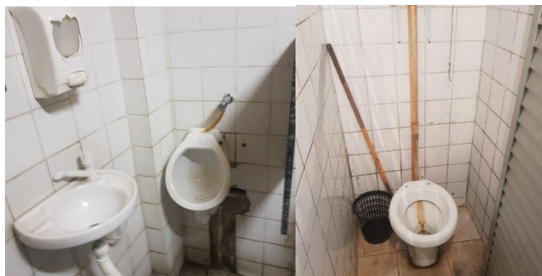
Figura 2 - Estado de conservação insatisfatória dos banheiros e falta de produtos de higiene pessoal. Fonte: Os autores (2019)
